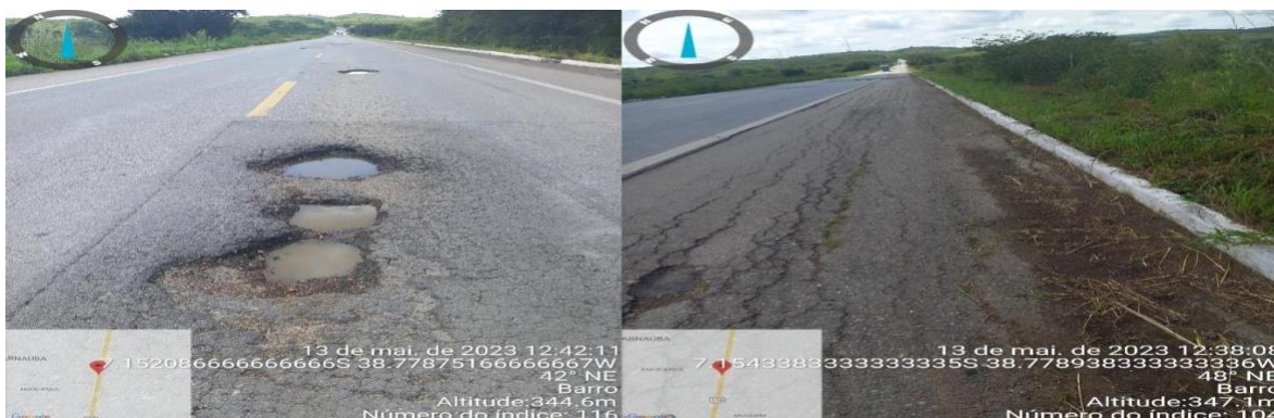
Figura 1- Painelas, Remendos e Trincas
